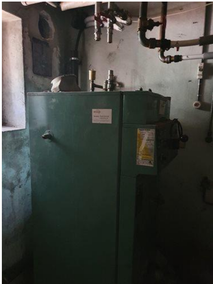
Première chaudière de 1973
